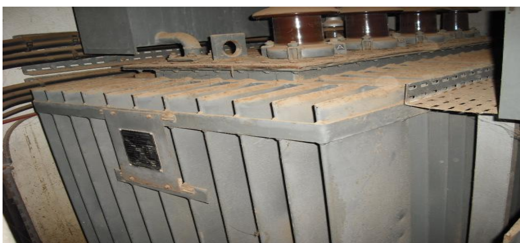
Photo : Transformateur hors service PCB au niveau de la centrale C3 du Cap des Biches
