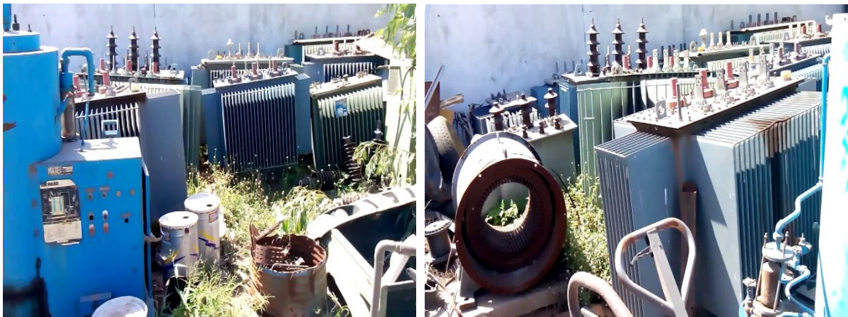
Photo : Transformateurs sur le dépôt de la SENELEC
